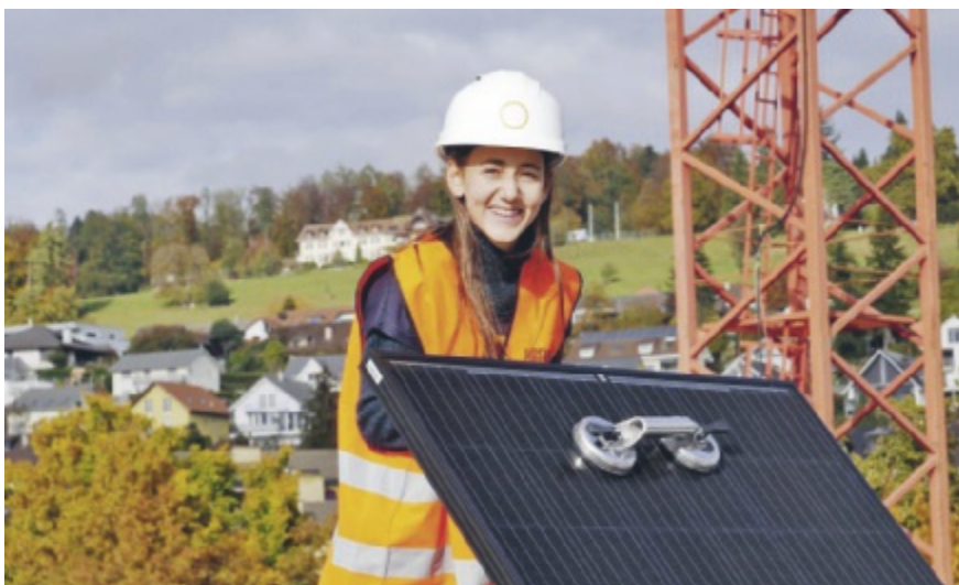
Bei Jugendsolar können Schülerinnen und Schüler auf einer Solarbaustelle im Aargau aktiv mitarbeiten.
